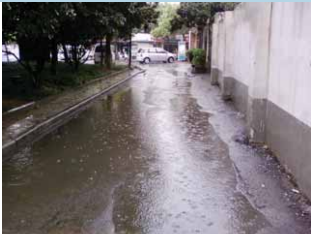
图1: 维修前的道路
