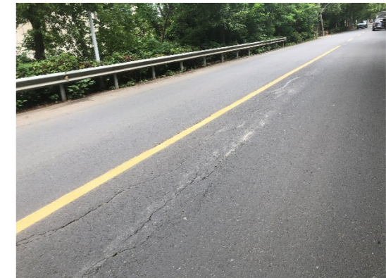
图 4-28 允埡桥东侧桥头纵向裂缝
