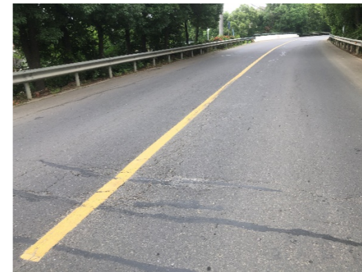
图 4-27 允埡西侧桥头纵向裂缝
