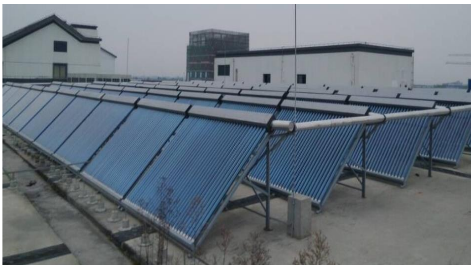
室外太阳能集热器实景图
